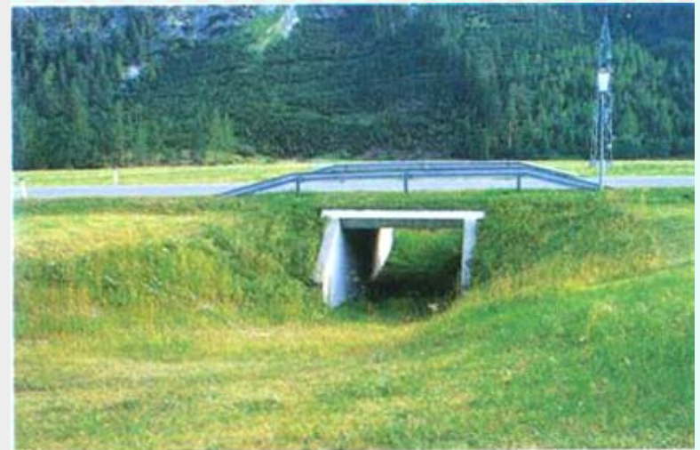
圖7.13 奧地利某動物穿越地下道
