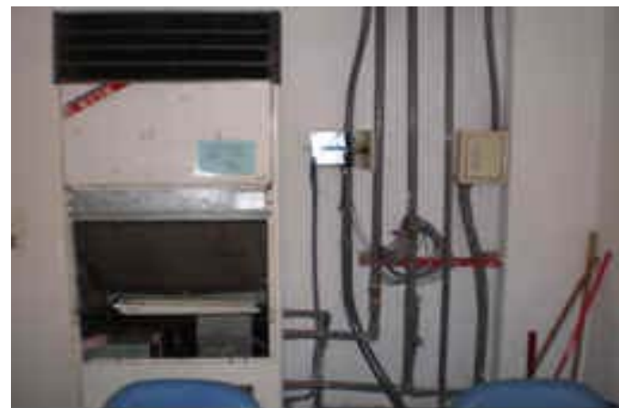
加裝冰水主機變頻模組
